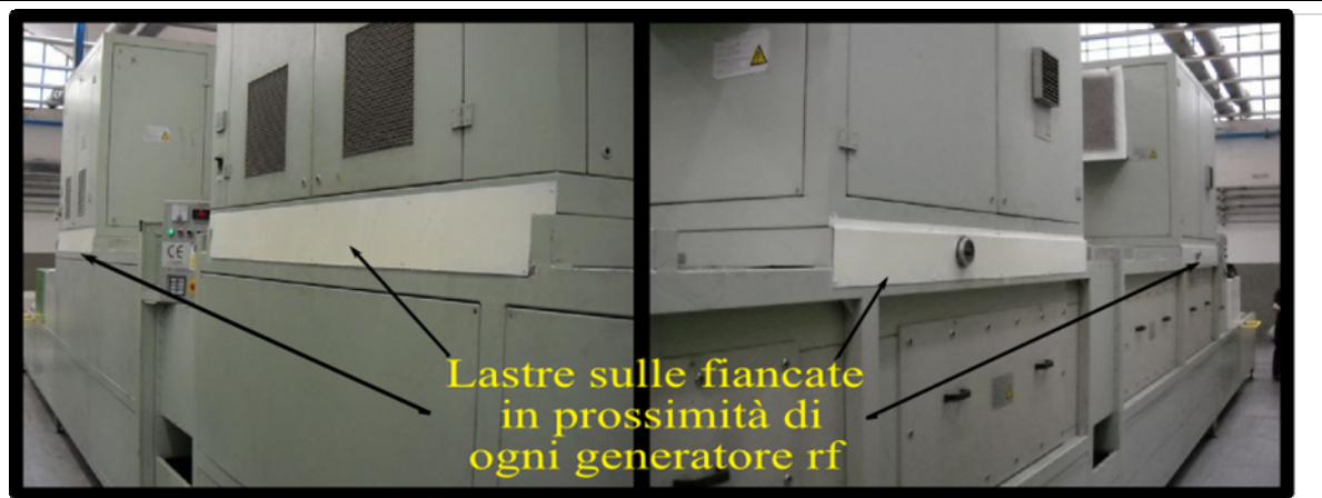
Fig 1: Lastre aggiunte ad ogni fiancata dei macchinari in prossimità di ogni generatore a radiofrequenza per contenere le emissioni elettromagnetiche sui lati.
